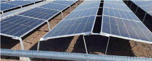
PV-Anlage Wasserbaulabor, Foto: Roman Smutny
