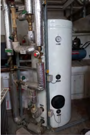
CIES WW-Bereitung Umrüstung auf dezentral Projektleitung und Foto: Valerie Kakoschke
